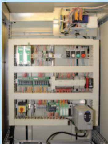
Шкаф автоматики до переоборудования
