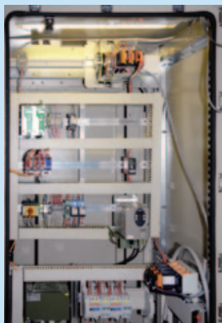
Шкаф автоматики после переоборудования
