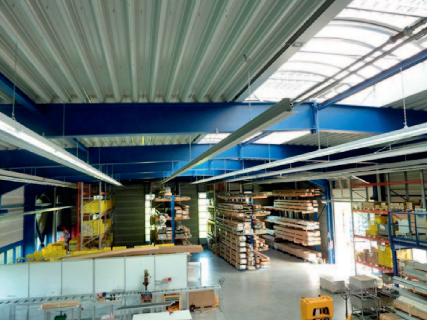
Рис. 2. Производственный цех с потолочными подвесными излучающими профилями (Германия)
